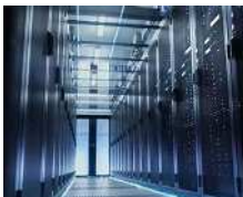
データセンター
